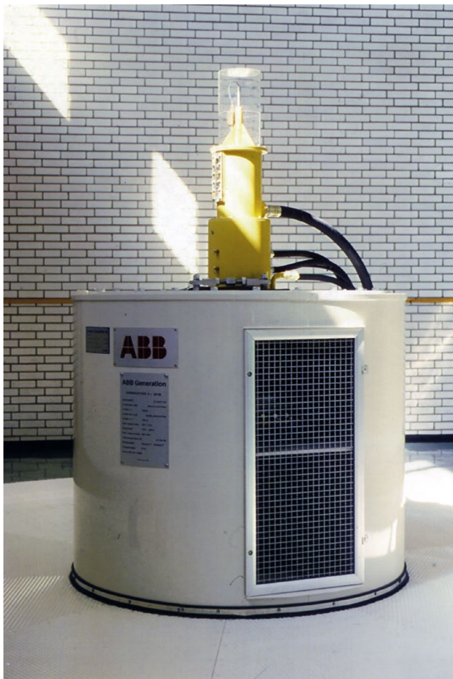
Raasakan voimalaitoksen generaattorin napa.
